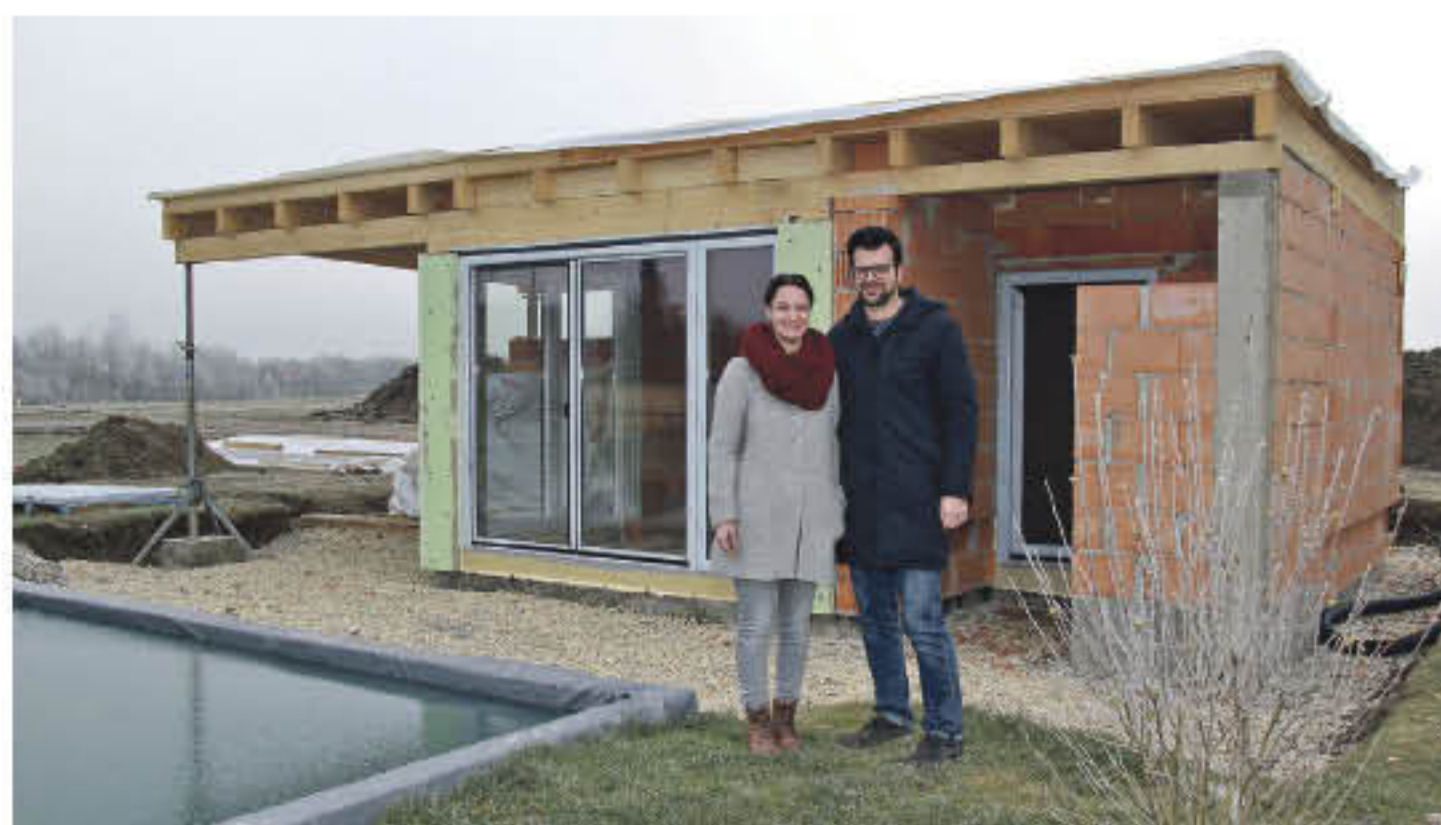
Familie Wallerstorfer freut sich über ihr neues Poolhaus. Im Frühjahr ist die Fertigstellung geplant.
